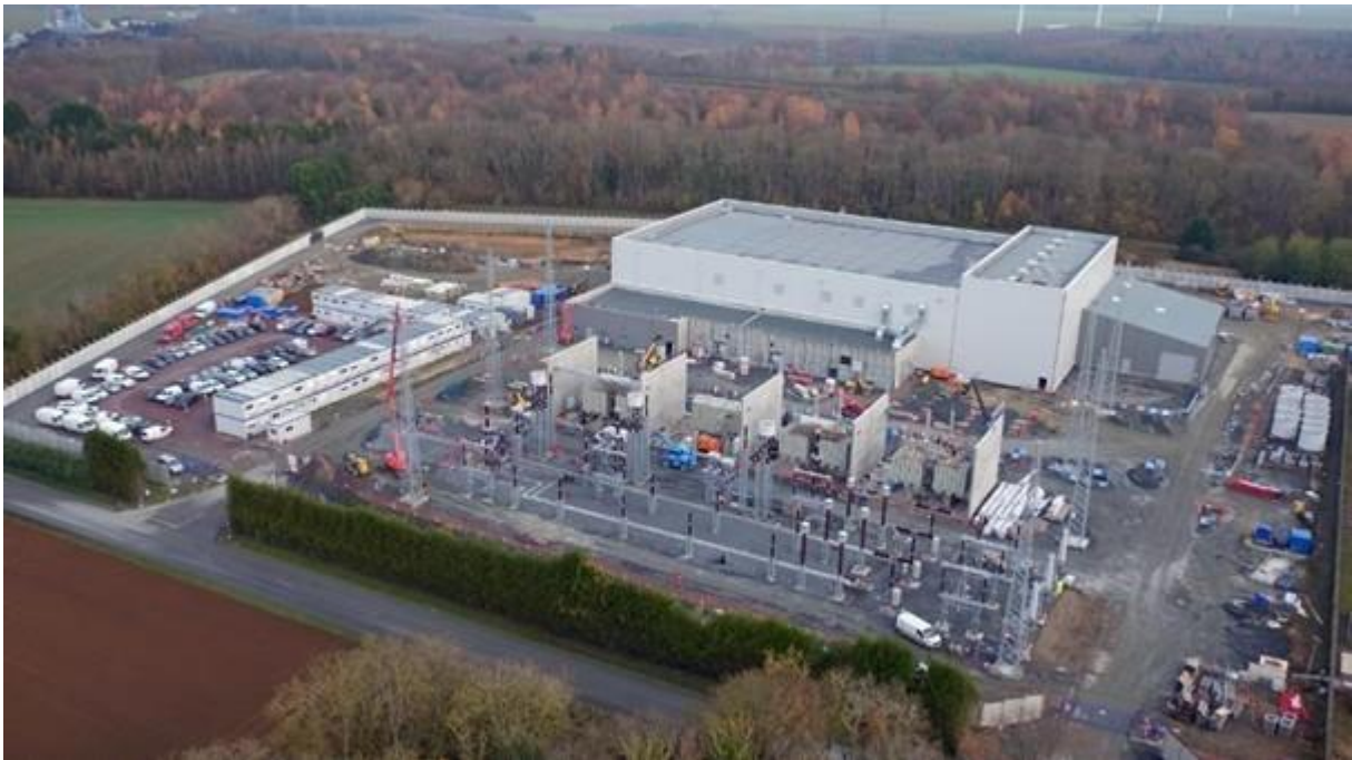
Figure 7 : Exemple de station de conversion existante – Chantier de Tourbe (à proximité de Caen)
